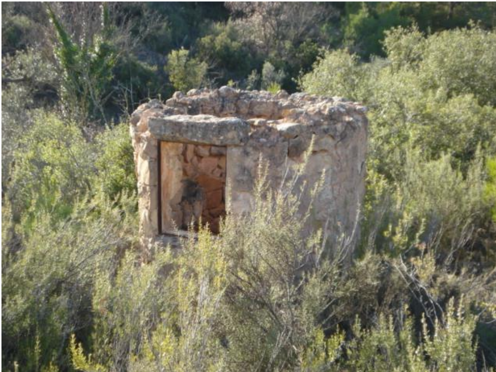
Aljibe en mal estado, por recuperar
