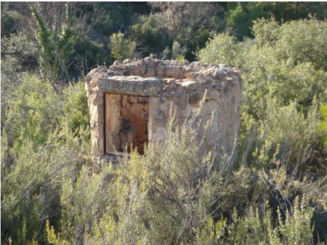
Aljub en mal estat, per recuperar
